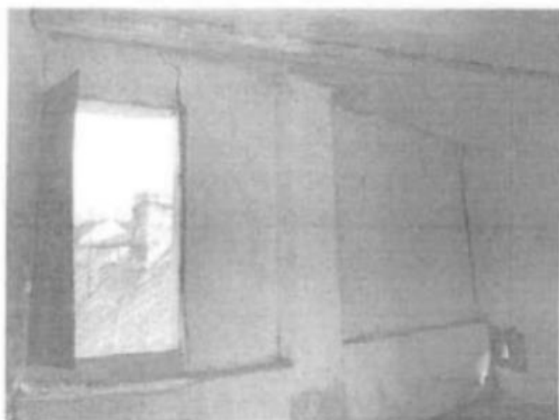
Obr.1-30: Narušené a popraskané štítové zdivo domu Václavské náměstí č.p.105 směrem k domu Mariánské údolí č.p.106, kominového tělesa domu č.p.106 a štítové stěny domu č.p.106 k pozemku par.č. 123:
