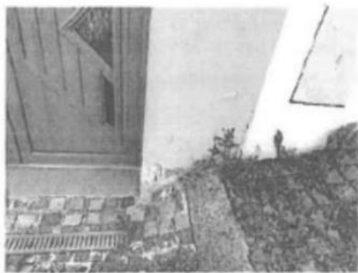
Obr.10: Narušené zdivo domu Mariánské údolí č.p.106
