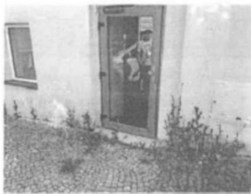
Obr.7: Narušené zdivo domu Mariánské údolí č.p.106
