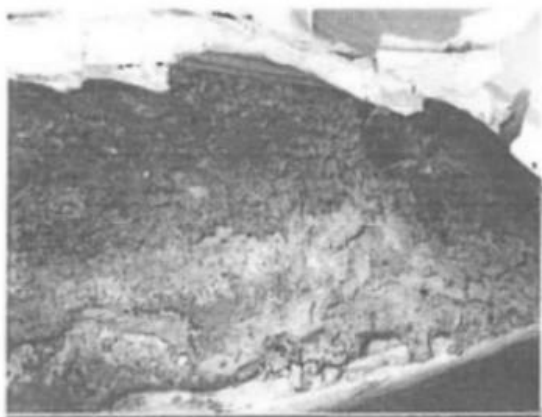
Obr.6: Narušené zdivo domu Václavské náměstí č.p.105
