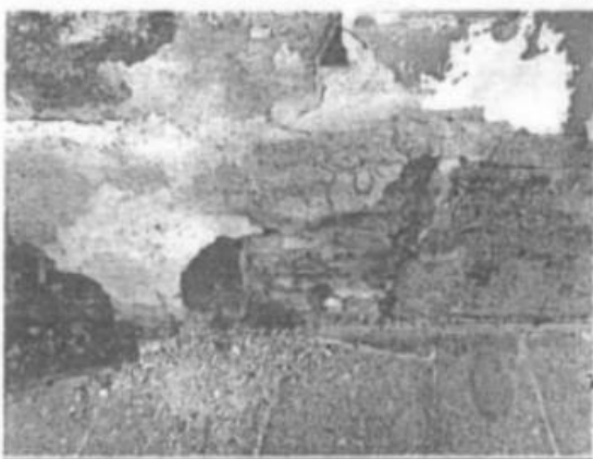
Obr.5: Narušené zdivo domu Václavské náměstí č.p.105
