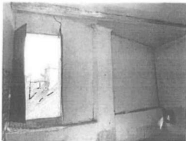
Obr.24-30: Narušené a popraskané štítové zdivo domu Václavské náměstí č.p.105 směrem k domu Mariánské údolí č.p.106. foto: 11.8.2021
