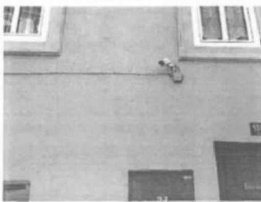
Obr.11: Narušené zdivo domu Mariánské údolí č.p.106
