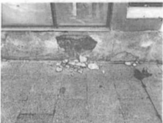
Obr.2: Narušené zdivo domu Václavské náměstí č.p.104
