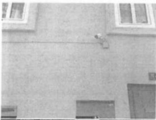
Obr.11: Narušené zdivo domu Mariánské údolí č.p.106
