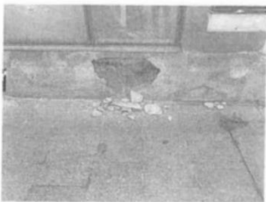
Obr.2: Narušené zdivo domu Václavské náměstí č.p.104
