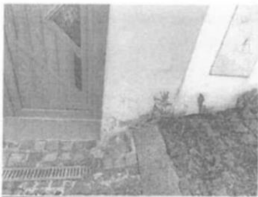
Obr.10: Narušené zdivo domu Mariánské údolí č.p.106
