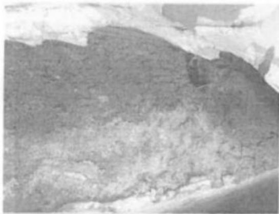
Obr.6: Narušené zdivo domu Václavské náměstí č.p.105
