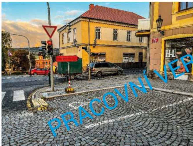
Obr. 11 Nevyhovující provedení a technický stav parkovacího stání pro osoby se sníženou schopností pohybu.
